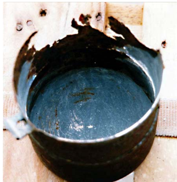
Bild 5: Sehr stark korrodierte Schutzhaube eines Kontrollankers.
