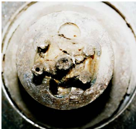
Bild 5: Freigelegter Kontrollankerkopf. Bei einer Litze fehlt der Zentraldraht!
