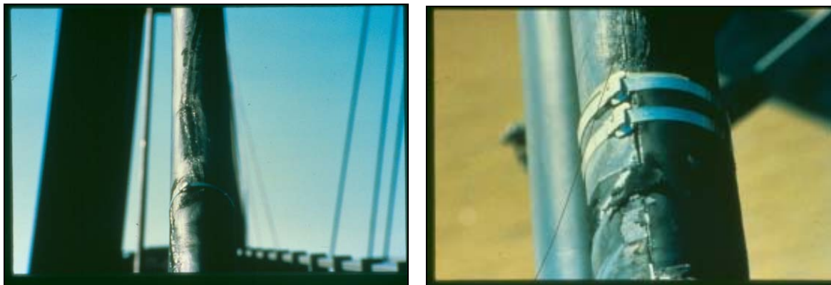
Bild 3.21 Risse im PE-Hüllrohr bei der Pasco-Kennewick-Brücke (Bilder Dr. W. Podolny).
