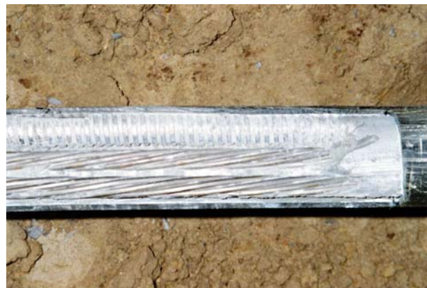
Bild 6: Hinter der Wand frei gegrabener und geöffneter Anker. Litzen ohne Korrosion (oben Injektionsrohr).
