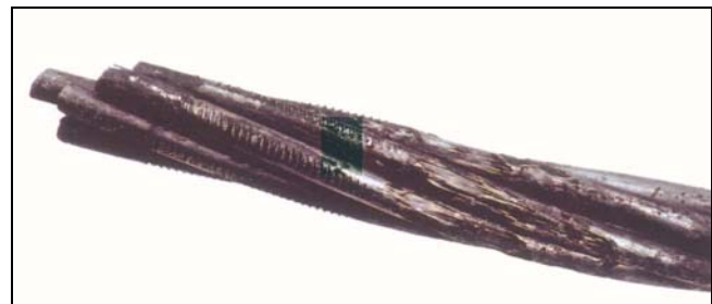
Bild 5: Noch nicht gebrochenes Litzenende auf der „intakten“ Seite: Starker Materialabtrag vor dem Stauchkopf.
