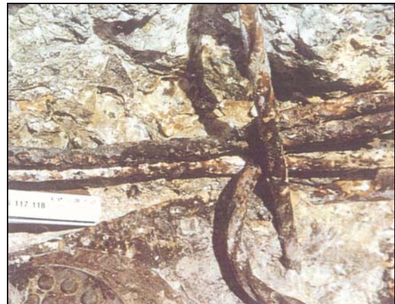
Bild 4: Korrosion der schlaffen Bewehrung neben der Spannische.
