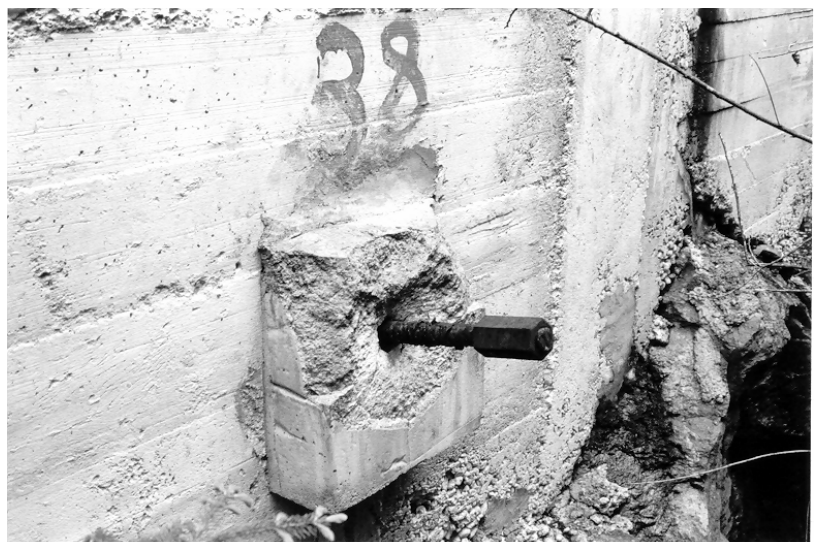
Bild 1: Durch Ankerbruch weg gesprengter Mörtelvorsatz.
