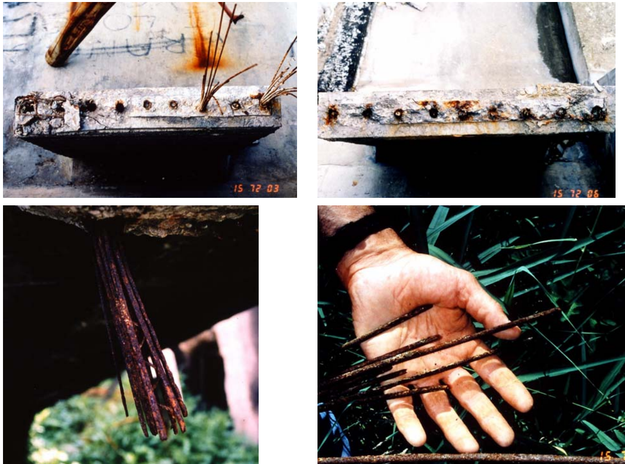
Bild 2.49 Details zum Zustand der Spannglieder und Spannstähle der Brücke über die Melle bei Gent, Belgien, nach dem Einsturz (Ministère Wallon de l'Équipement et des Transports).
