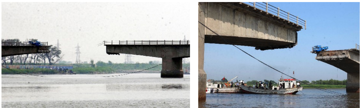
Bild 2.67 Teileinsturz der Tianzhuangtai-Brücke über den Fluss Liaohe im nordöstlichen China am 10. Juni 2004 [Int 2004g].
