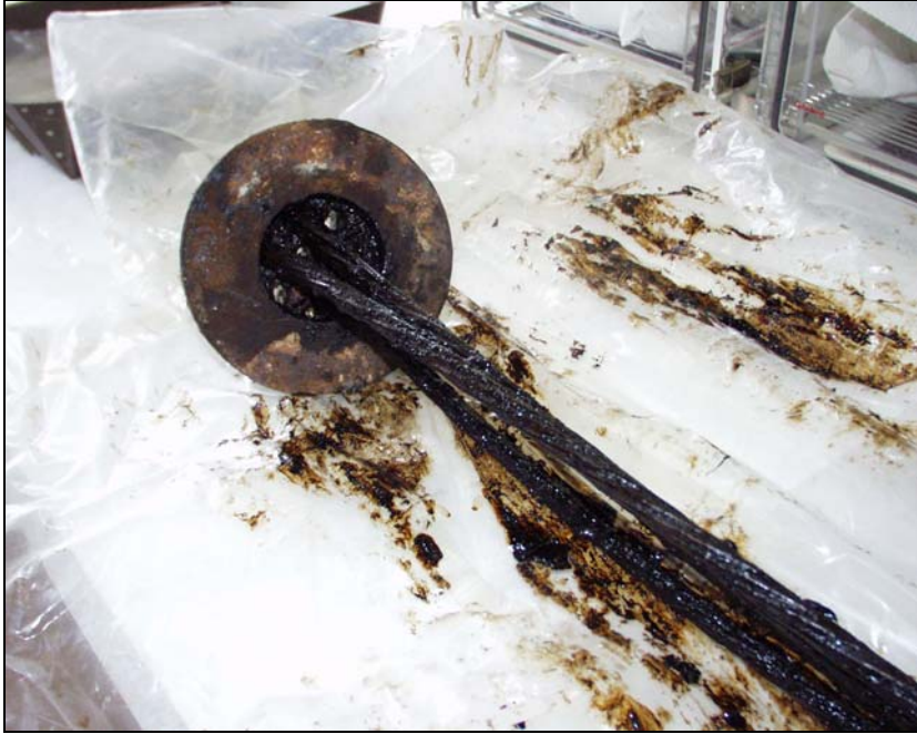
Bild 7: Spannkopf des Kontrollankers mit 4 fettbedeckten Litzenabschnitten im Anlieferungszustand.
