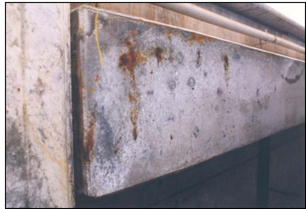
Bild 5: Korrosionsspuren am Trägeranfang (Untersicht eines Trägerunterflansches).
