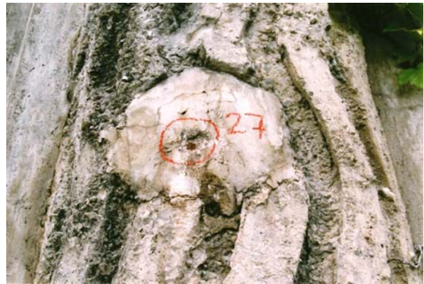
Bild 3: Im schlechten Nischenbeton ist ein angerostetes Litzen-Ende sichtbar!
