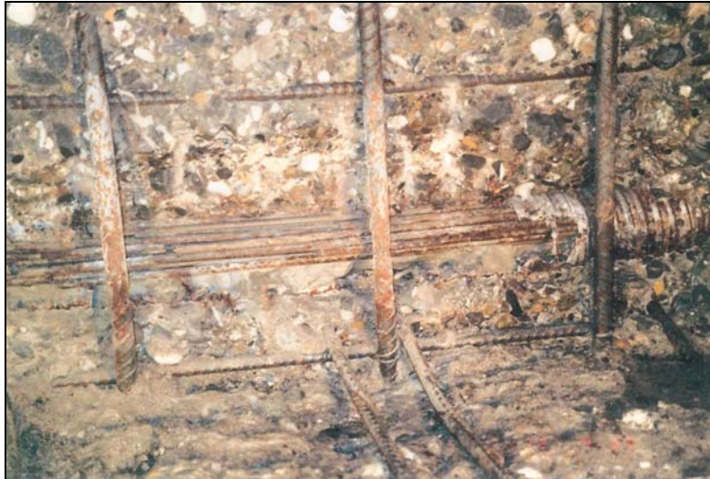
Bild 6: Korrodierte Drähte der Längsvorspannung (mittels HDW freigelegt)
