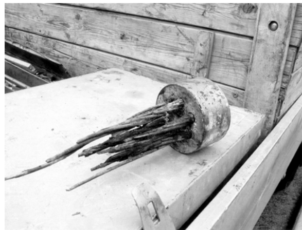
Bild 4: Frei gelegter Ankerkopf. Alle 6 Litzen gebrochen!
