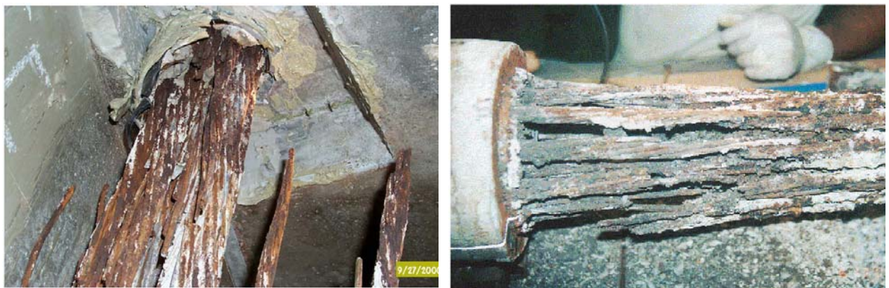
Bild 2.59 Korrosion an den Spannstählen direkt unterhalb des Säulenkopfes (links) und im Bereich der Trompete (rechts) bei der Sunshine Skyway Bridge [Theryo 2002].
