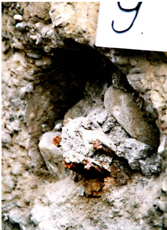
Bild 4: Teilweise freigelegter Ankerkopf mit angerosteten Litzen. Nischenbeton vermischt mit Steinen.
