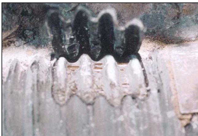
Bild 4: Litzen sind im Tiefpunkt an die Hüllrohrwand gepresst worden (keine alkalische Einbettung).
