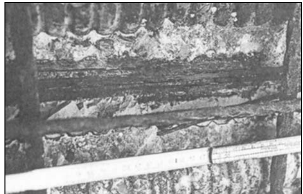
Bild 3: Durchkorrodiertes Hüllrohr und durchkorrodierte Spanndrähte.
