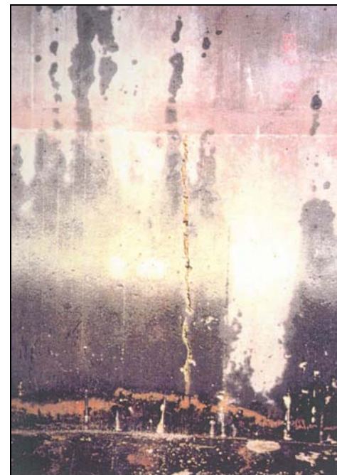
Bild 2: Riss in der Behälterwand.
