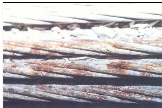
Bild 5: Korrosion an den Spannlitzen.
