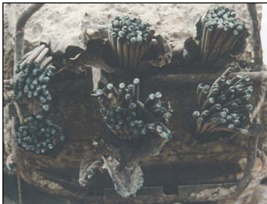
Bild 5: Deformierte Hüllrohre (Unterseite).
