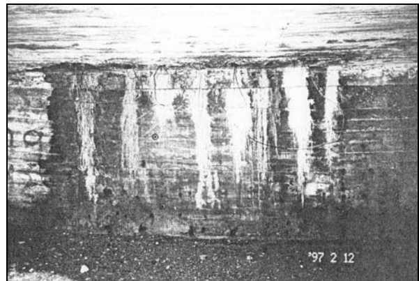
Bild 5: Wassereintritt durch Elektrorohre.
