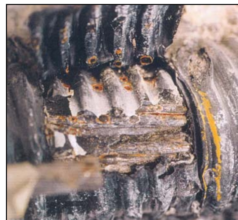
Bild 5: Korrosion am Spannstahl bei einem Hochpunkt.
