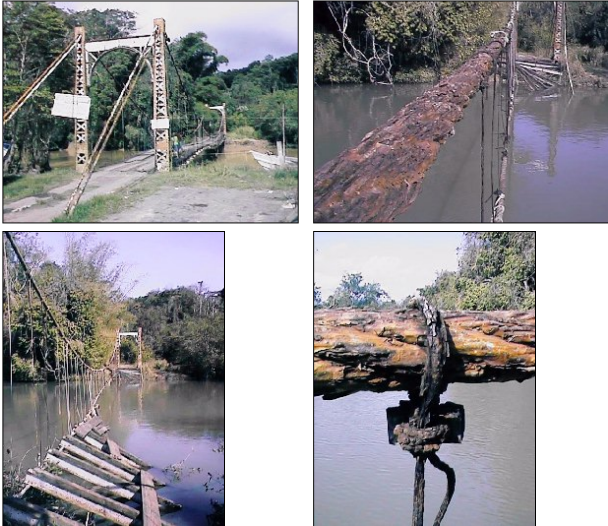
Bild 3.20 Lance Mitán-Hängebrücke über den Moruga-Fluss im Süden der Karibik-Insel Trinidad vor und nach dem Einsturz 1998 und Zustand der Hängeseile und der Hänger [Int 2004k].
